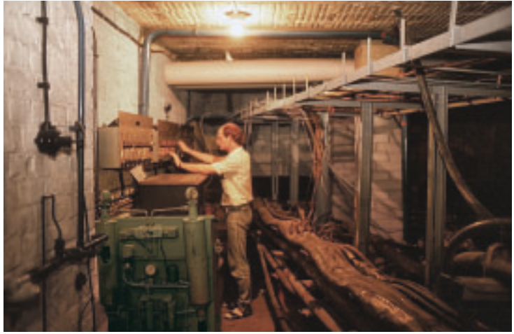
Maroder Kabelkeller des ehemaligen Dresdner Fernmeldeamtes, 1991.
